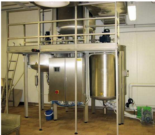
Anlage zur automatischen Herstellung von bis zu 600 Litern Flüssigaspik pro Stunde.
